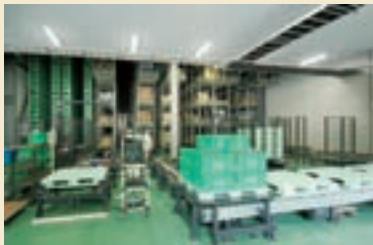
物流用大型立体自動倉庫
