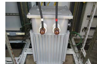
変電設備の更新(細江事業所)
