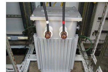
変電設備の更新(細江事業所)
