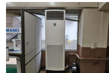
高効率空調機への変更(本社)
