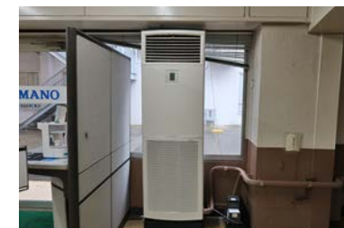
高効率空調機への変更(本社)
