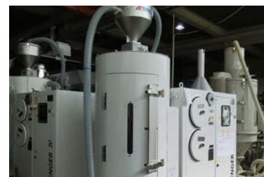
従来比で消費電力の少ない樹脂材料用除湿乾燥機に更新(相模原事業所)
